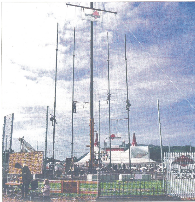
Der Zaun wächst und wächst: Die Arbeiter in luftiger Höhe waren natürlich alle vorschriftsgemäss gesichert und trugen Bauhelme. (Bild Margreth Rinderknecht)
