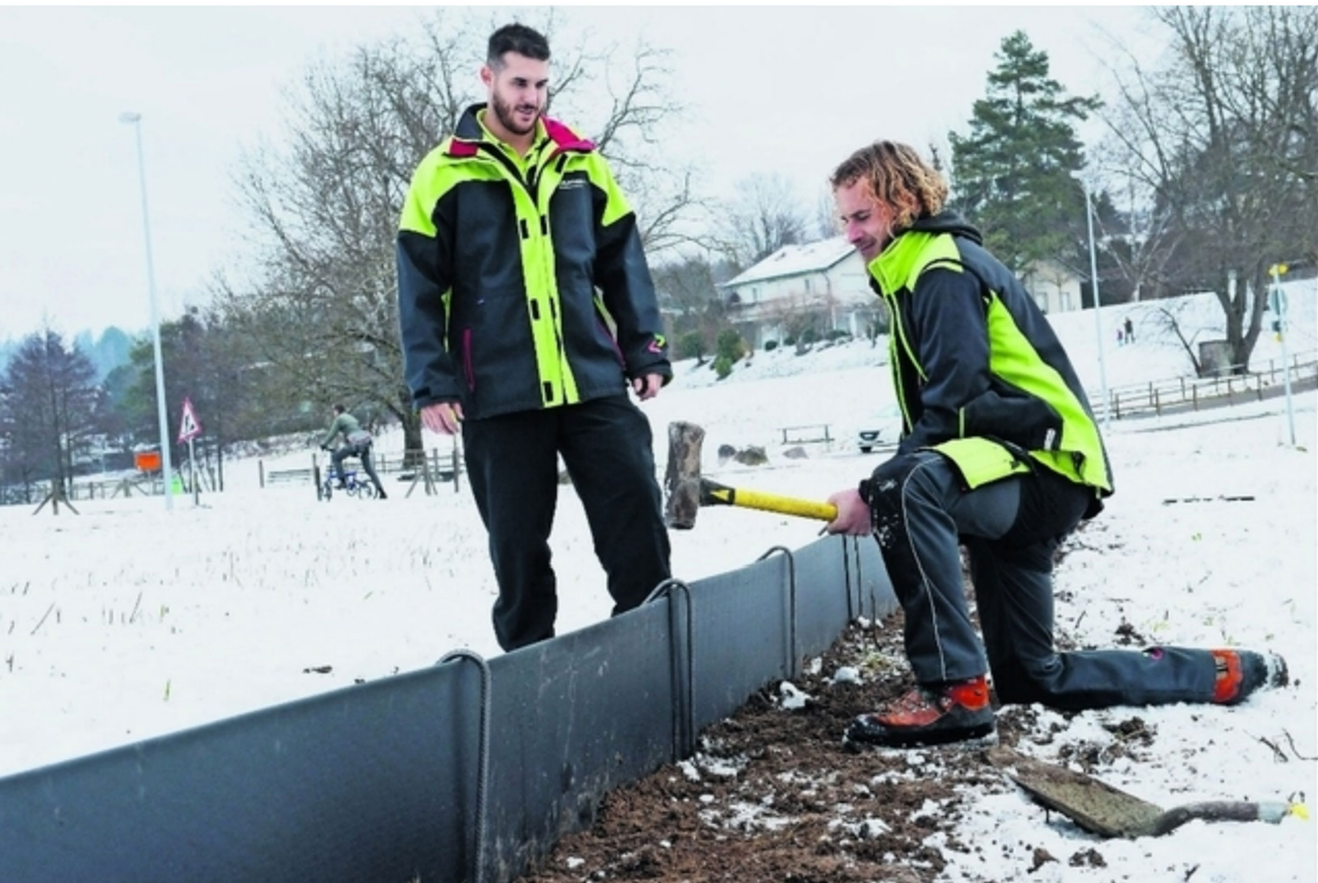
Der neue Zaun, den Christian Bischof (links) und Alan Barrett aufstellen, soll Amphibien vor dem Sturz in eine Baugrube bewahren. (Bild: Reto Schneider)
